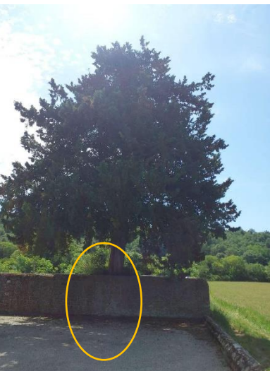
Figure 14 : arbre n°23, fissure sur le mur, provoqué par l'accroissement en diamètre du tronc.
